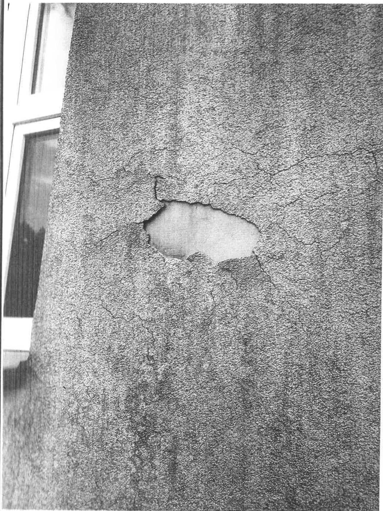
Uszkodzenie tynku cienkowarstwowego elewacji sali gimnastycznej
