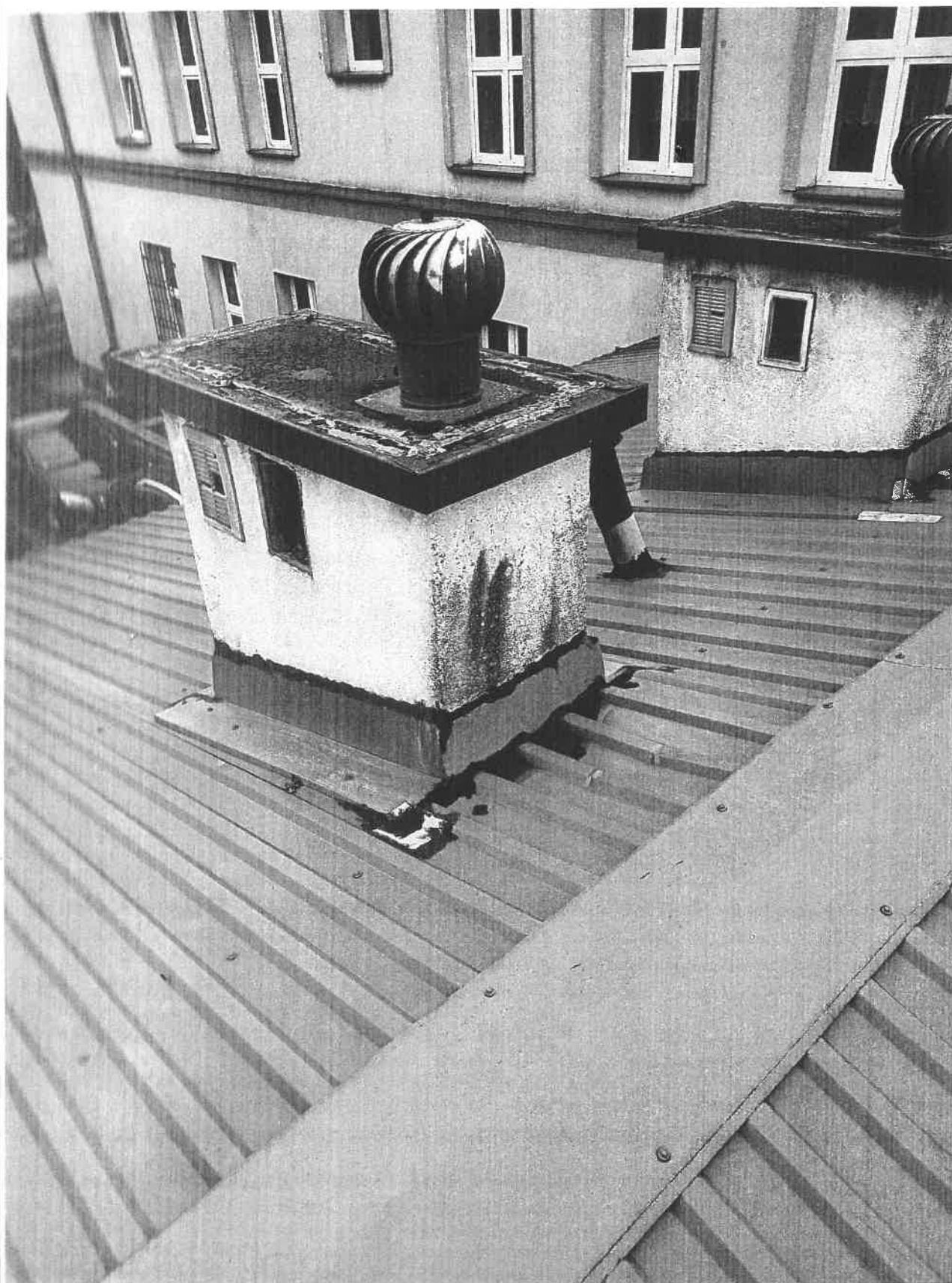
Otrakujące kratki przewodów wentylacyjnych łącznika.
