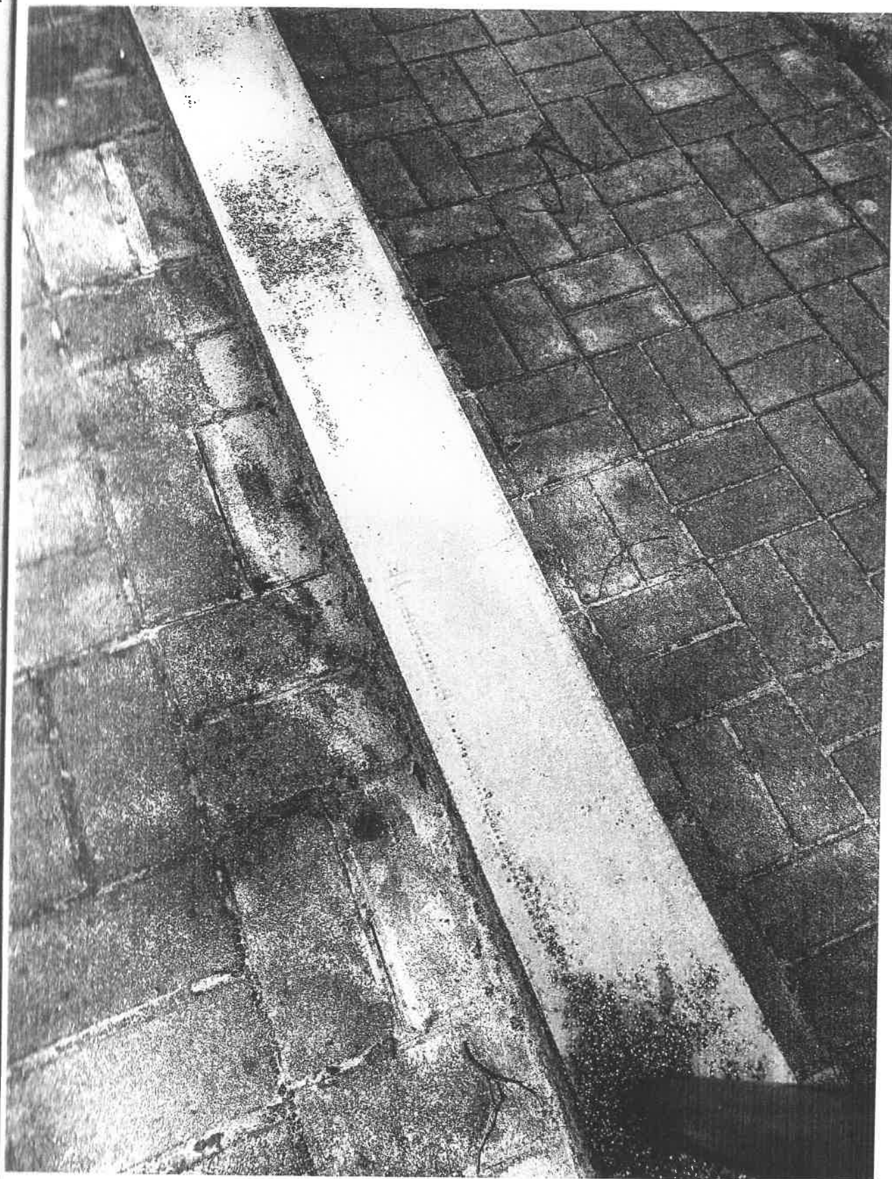
Ubytki tynku mozaikowego muru oporowego
